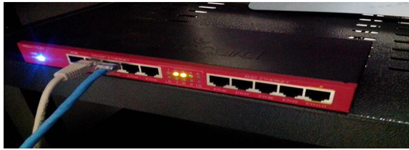
Figura 07: Mikrotik RB2011 instalada
