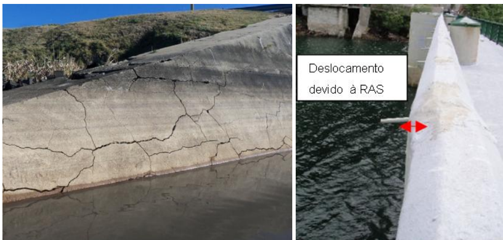
(a) Fissuração generalizada.
